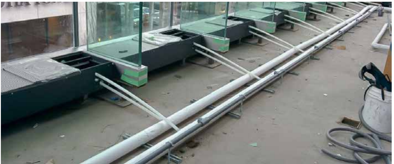
Clima Canal H19: Instalación
